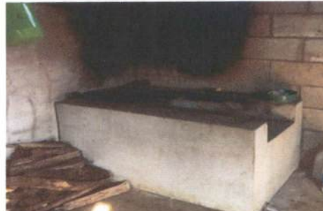
Foto 4: Estufa de la escuela sin chimenea y sin plancha de meta.
