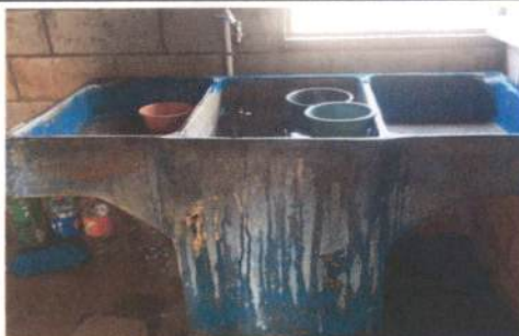
Foto 5: Pila de la cocina muy dañana por el paso del tiempo.
